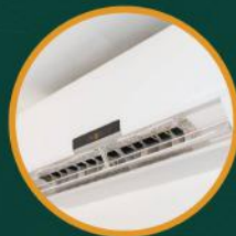
AIR CONDITIONER DI SETIAP LANTAI
